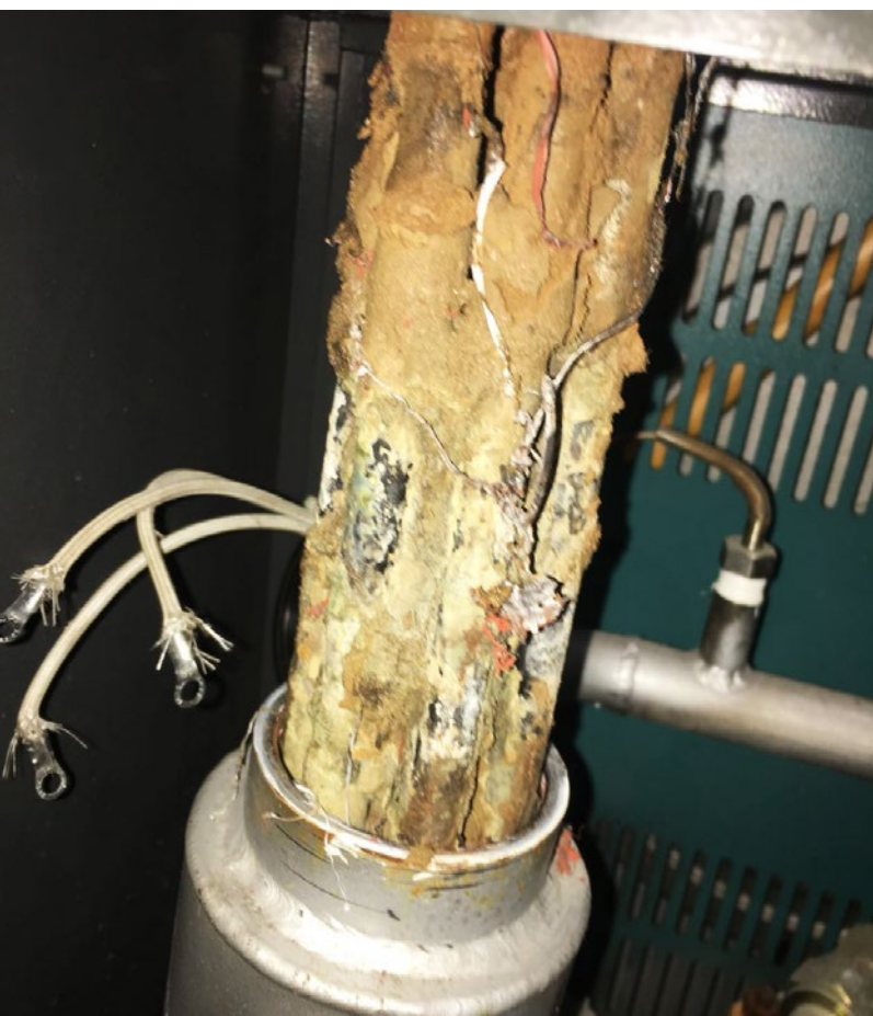
Échangeur de chaleur non traité pendant 3 ans.
