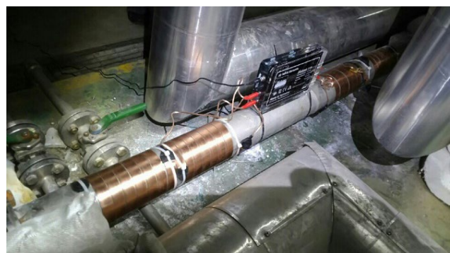
Vulcan S25 installé chez Toray Industries
