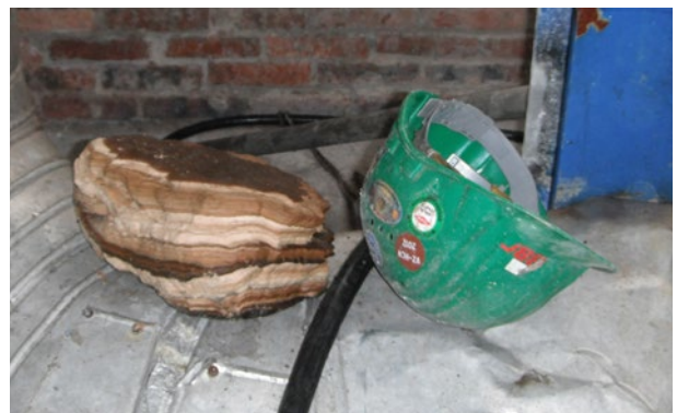
Dépôt éliminé sur la conduite après installation de Vulcan
